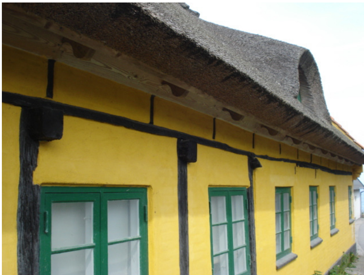
Fine detaljer ved tagudhæng, bindbjælker, tagskægskvist og kitfalsvinduer
